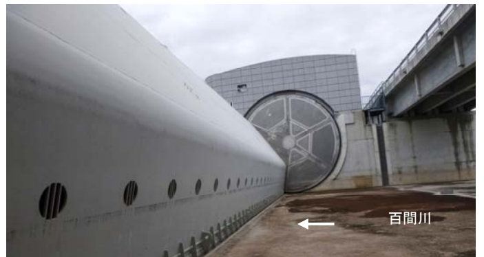
平成 water gate (ライジングセクターゲート: 仮締切中)
