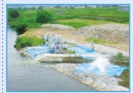
排水ポンプ車
