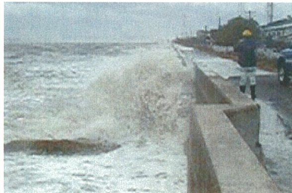
倉敷市玉島乙島地区の越波状況 (平成16年8月30日 台風16号)
