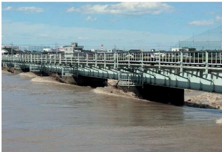
▲橋脚流木がに引っ掛りせき上げが生じた事例
