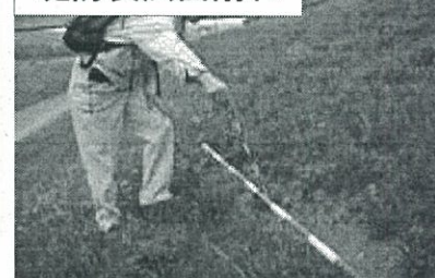
堤防表法面削れ
