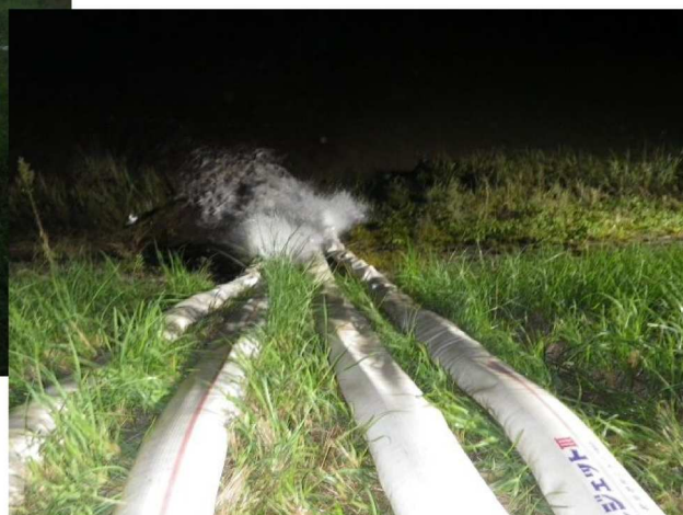
排水ポンプ車稼働状況 (H25.9.16)
