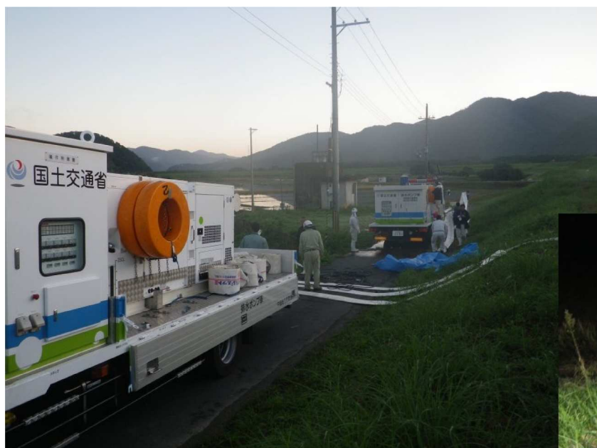
排水ポンプ車稼働状況 (H25.9.17)
