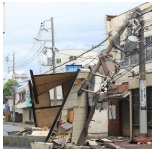
＜飛来物による電柱倒壊の事例＞
