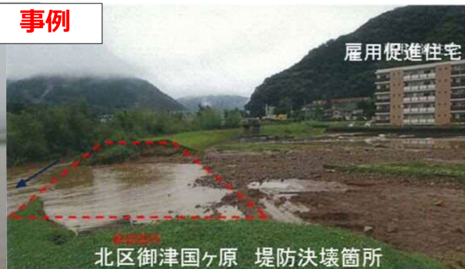
平成30年7月8日旭川堤防決壊箇所（岡山市北区） 出典：平成30年7月豪雨における状況/岡山市
