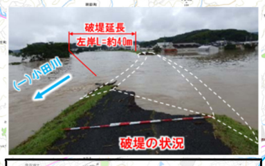
【堤防の決壊】L=約40m 小田川左岸16k100付近(県)
