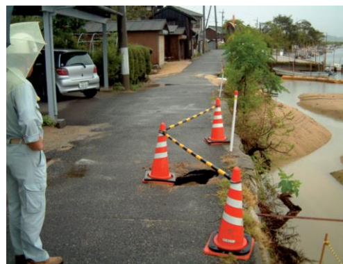
高潮被害状況 (平成16年8月:西幸西地先)
