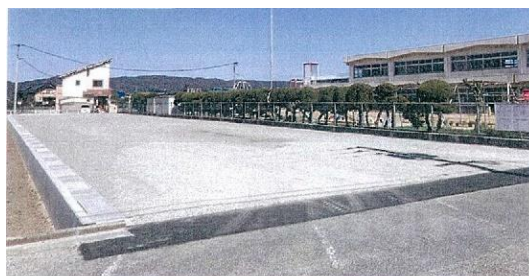
採石貯留槽 設置状況
