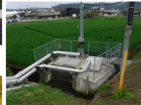
首高排水ポンプ （西江原町栢戸地内）
