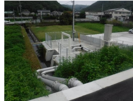
西町下水路排水ポンプ （西江原町雄神地内）
