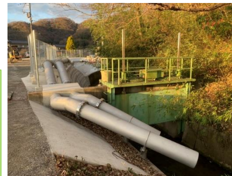
伊賀寺1号雨水幹線排水ポンプ （高屋町曲り地内）
