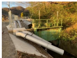
伊賀寺排水ポンプ場
