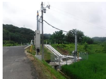
首高排水ポンプ場
