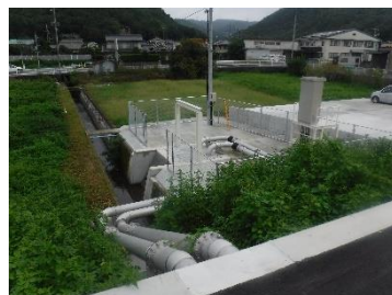
西町排水ポンプ場
