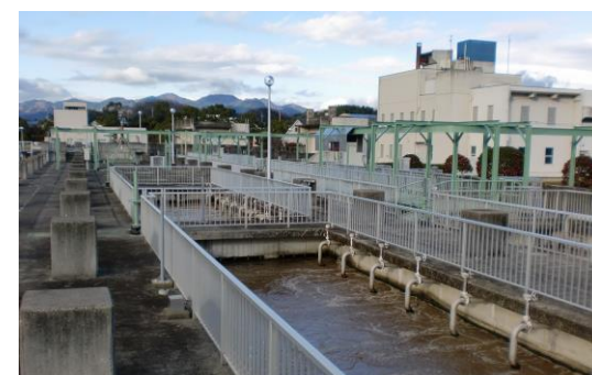
津山浄化センター
