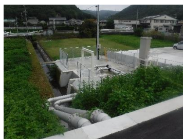
西町排水ポンプ場 (R3新設)
