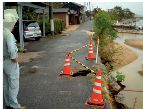
高潮被害状況 (平成16年8月:西幸西地先)
