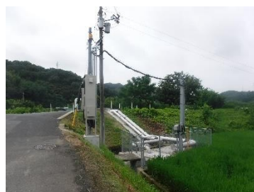
首高排水ポンプ場 (R3増設)
