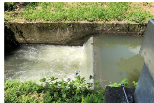
古地取水転倒堰の事前操作
