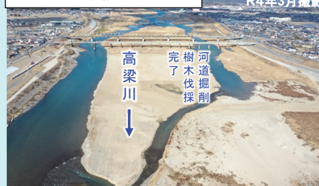
川辺地区（倉敷市）の状況
