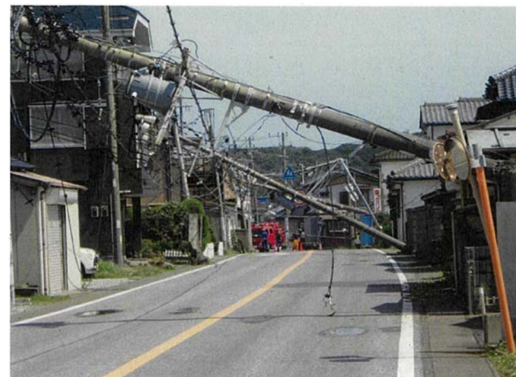
電柱倒壊 館山市船形
