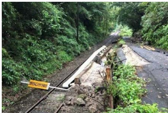
ガードレールが倒れ込んだJR姫新線新見-岩山間の線路 = 4日午前（山陽新聞：JR西日本岡山支社提供）
