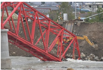
千曲川左岸側（上田）で崩落した別所線の鉄橋 (写真出典：信濃毎日WEB)
