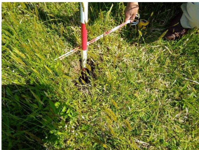
低水護岸の陥没状況(吉井川)
