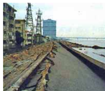
地震による堤防の崩壊状況 (阪神淡路大震災・淀川)
