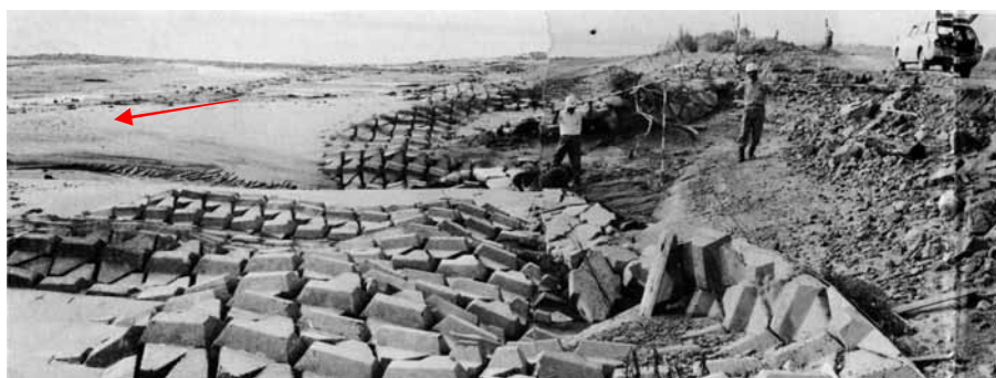
倉敷市鶴新田 低水護岸被災状況
