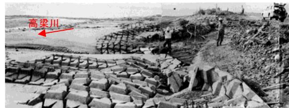
倉敷市鶴新田 低水護岸被災
