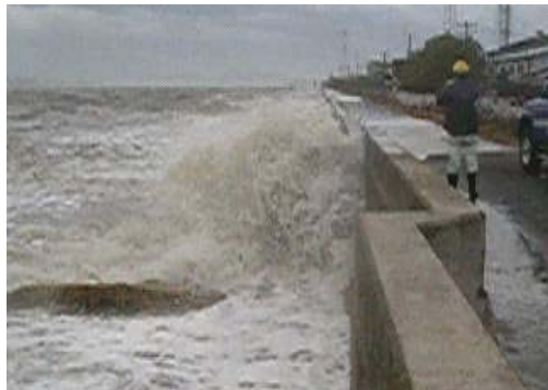
位置：倉敷市玉島乙島地区 高梁川の高潮越波状況（平成26年台風16号）
