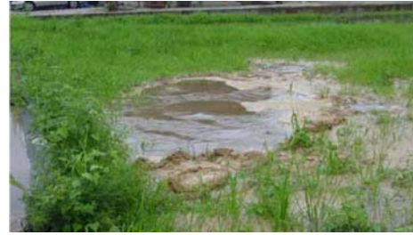
砂の噴出に伴う陥没の発生状況 (H18. 7 洪水、総社市清音地区)
