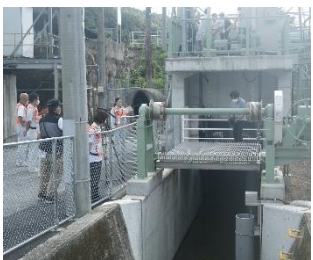
内水排水機場
