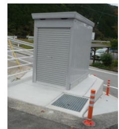
内水排水ポンプ
