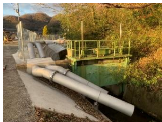
伊賀寺排水ポンプ場
