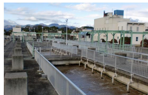
津山浄化センター
