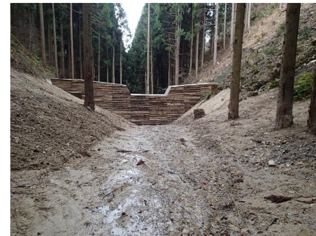
流木撤去の実施状況
