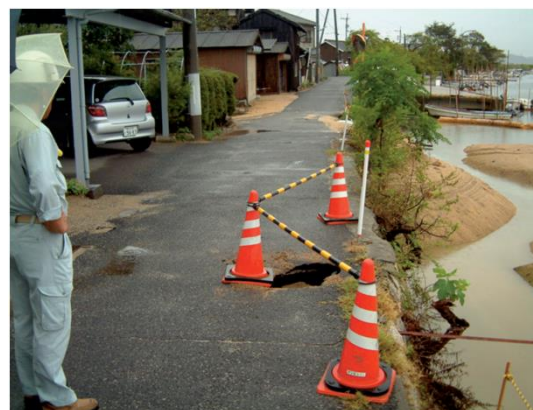
高潮被害状況 (平成16年8月:西幸西地先)
