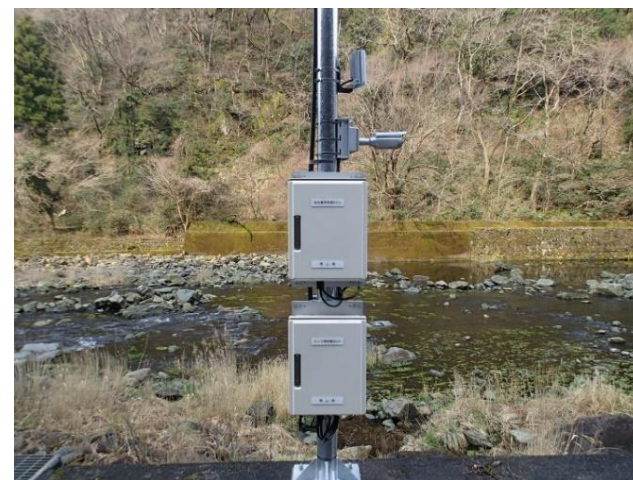
簡易型河川監視カメラ
