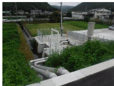
西町排水ポンプ場 (R3新設)
