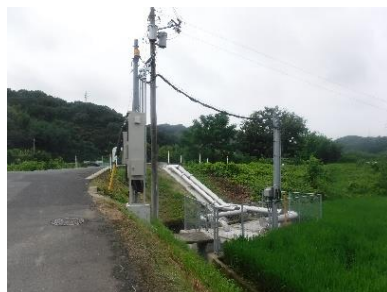
首高排水ポンプ場 (R3増設)
