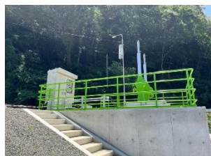
与井排水ポンプ場
