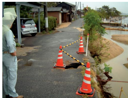
高潮被害状況 (平成16年8月:西幸西地先)
