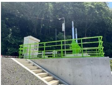
与井排水ポンプ場 (R7新設)
