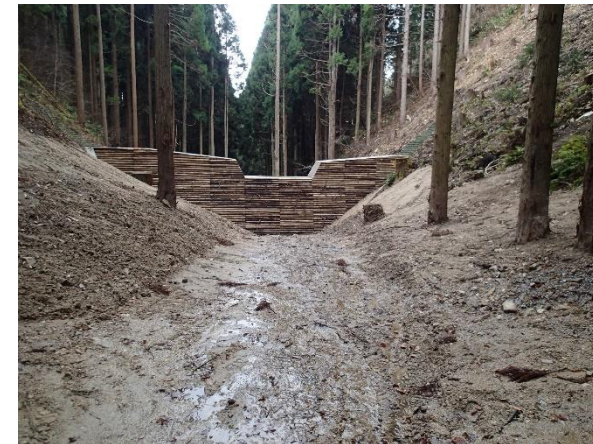
流木撤去の実施状況
