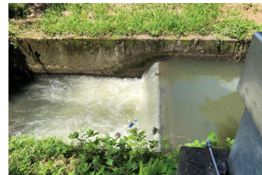
古地取水転倒堰の事前操作
