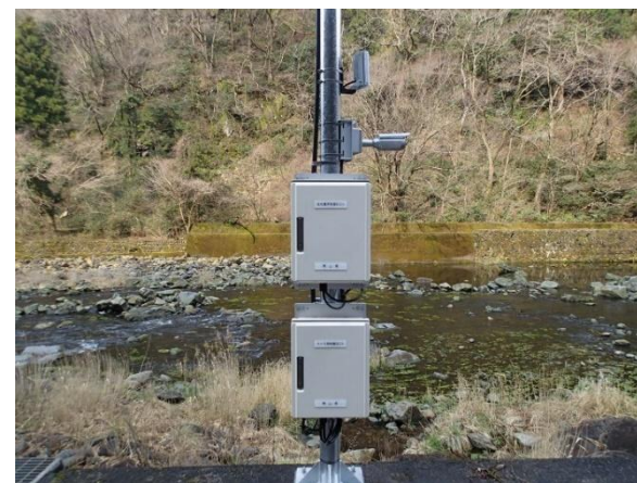
簡易型河川監視カメラ
