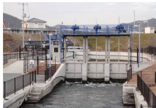
湛井堰ゲートの事前操作
