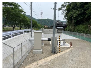
梶江排水ポンプ場 (R7新設)
