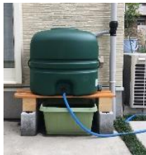
雨水タンク設置事例
