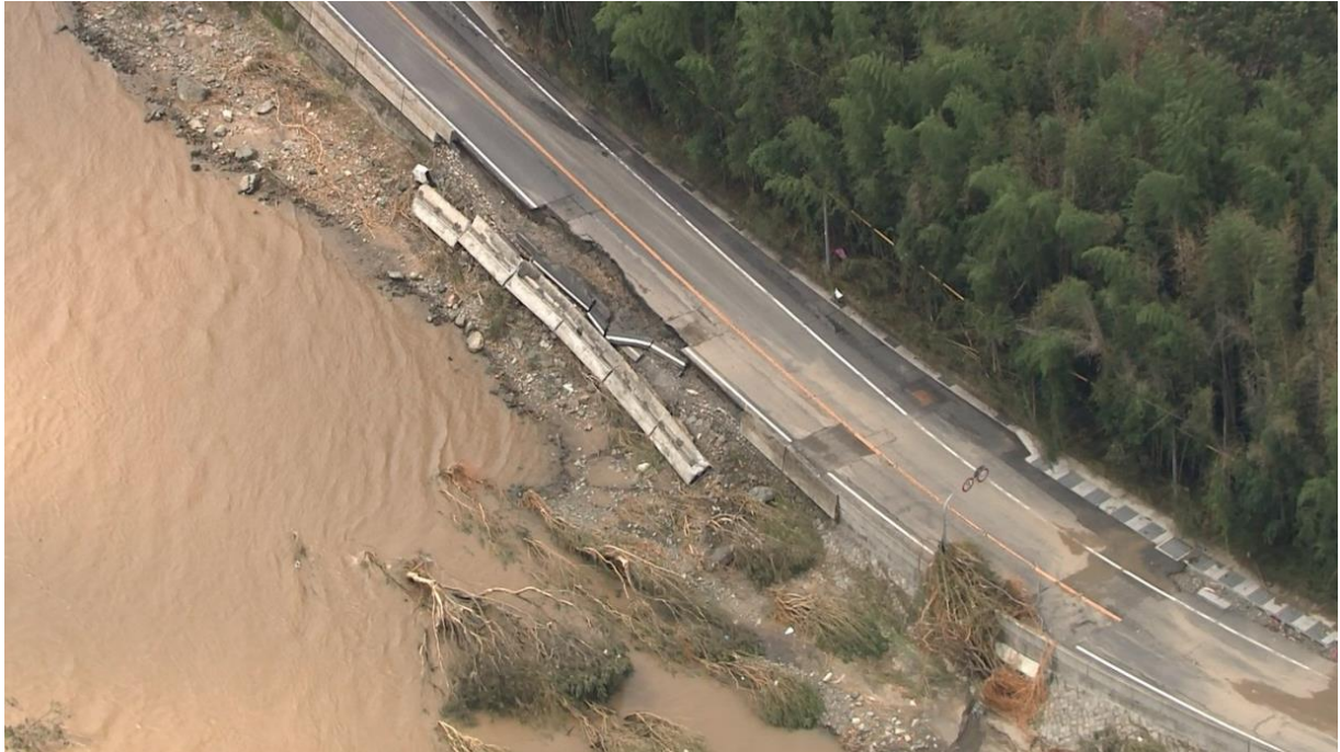
△総社市種井における護岸崩壊状況（ヘリ画像）
