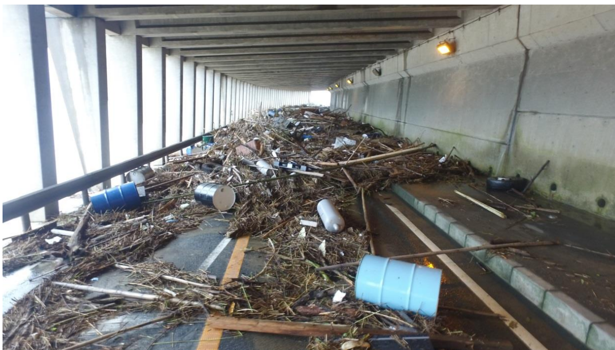
△総社市美袋洞門における瓦礫堆積状況
