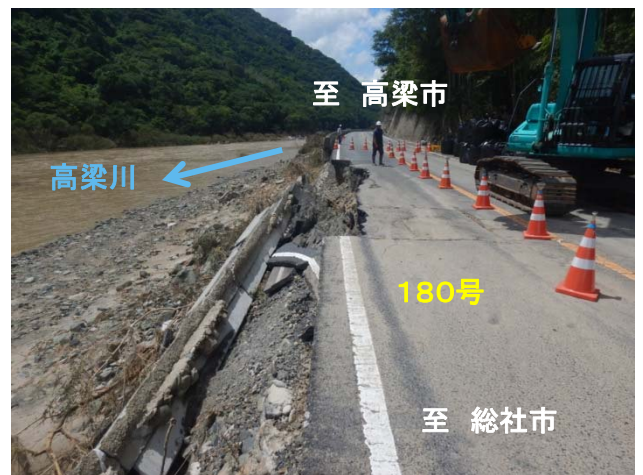
被災箇所(H30.7撮影)
