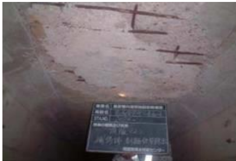
函渠下面の剥離・鉄筋露出
