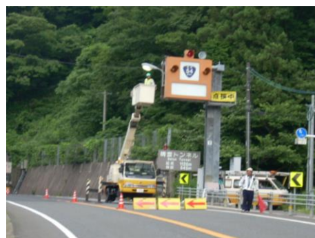
警報設備点検
