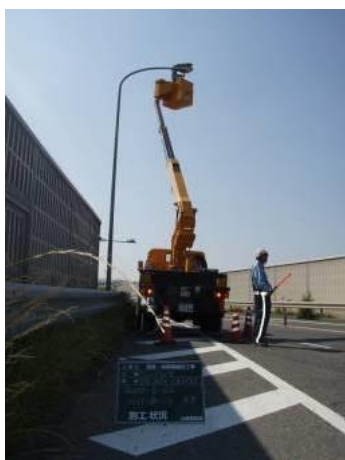
道路照明球替
