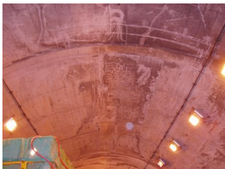
コンクリート剥落防止対策前
