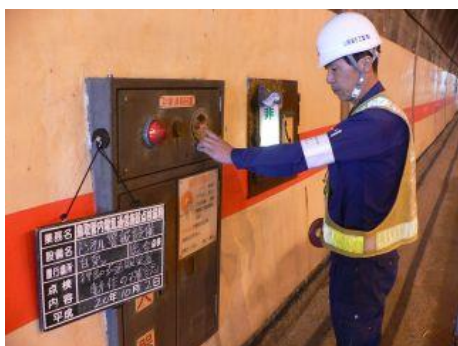
電気設備点検（トンネル警報設備）
