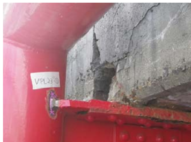
ゲルバー部の地覆コンクリート欠損
