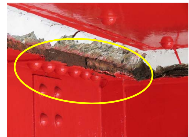
床版ハンチ部の剥離・鉄筋露出
