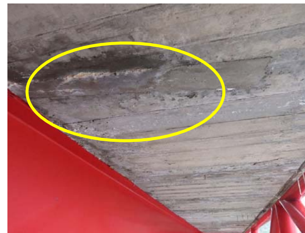
張出床版の漏水・遊離石灰
