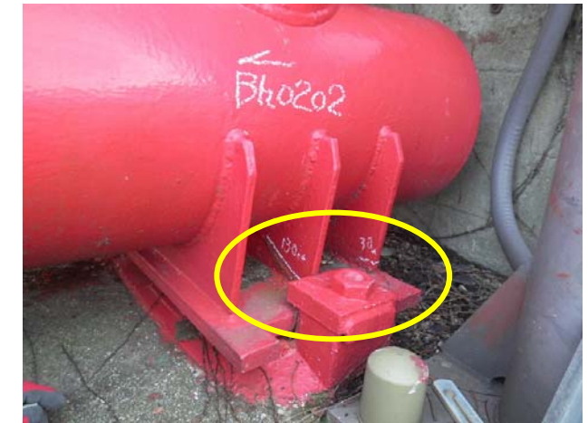
支承補剛リブの亀裂
