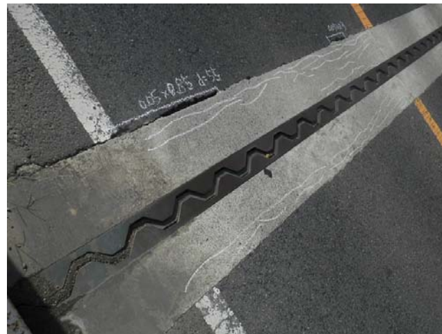
伸縮装置付近（A2 橋台）の路面の凹凸
