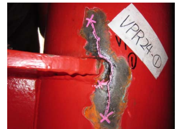
亀裂のマーキング状況
