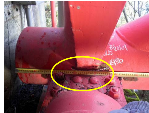
補剛桁下弦材の亀裂
