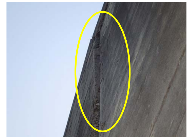
取付擁壁 (A2 橋台側) の沈下・移動・傾斜
