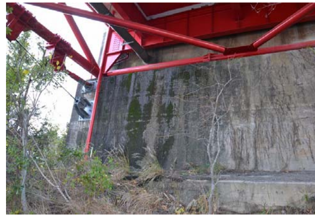
A2 橋台壁の漏水・滞水
