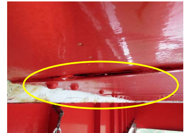
床版の鋼板接着のうき
