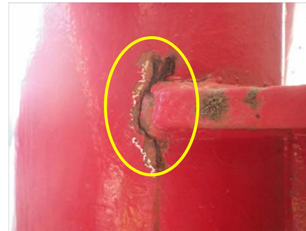
補剛桁垂直材の亀裂
