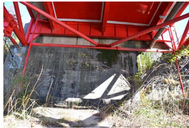
A1 橋台壁の漏水・滞水
