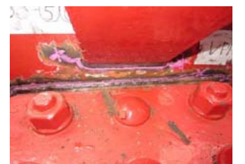
VPR03-⑦ 注: 下側の亀裂が⑦
