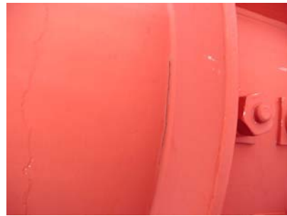
耐震補強部材とアーチリブの接合部の塗膜割れ
