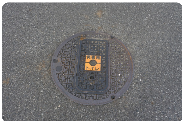
多目的トイレの鉄蓋
