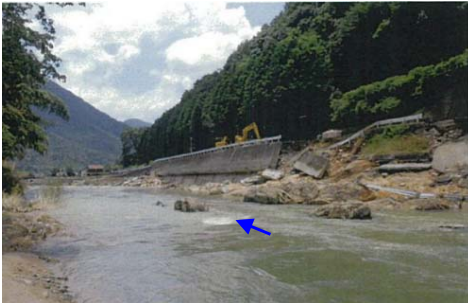
▲護岸の被災状況
