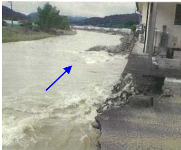
▲家屋の被災状況
