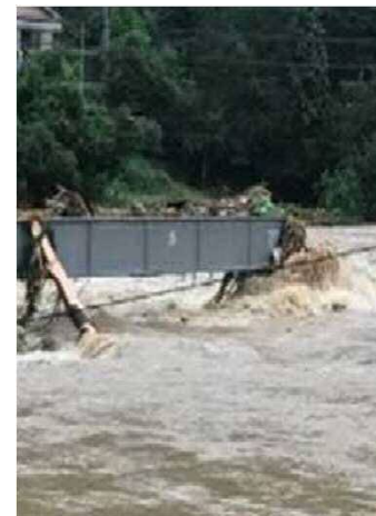
崩壊した橋梁
