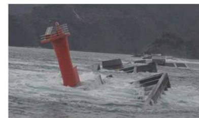
被災した防波堤(釜石港)
