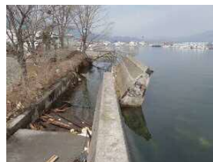
被災した海岸堤防(大船渡港海岸)
