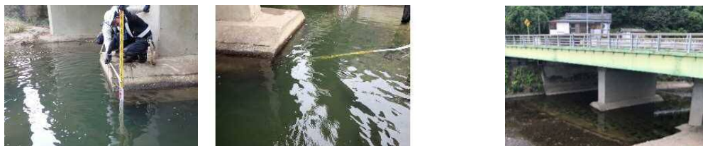
最大1.1mの洗堀を確認
