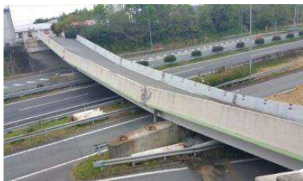
緊急輸送道路上の橋梁の崩落
