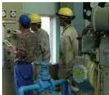
現地で施設の操作
