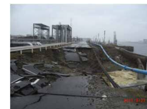
岸壁の被災(鹿島港)
