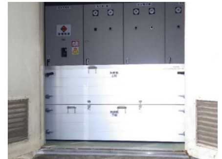
止水板による受変電設備への浸水対策
