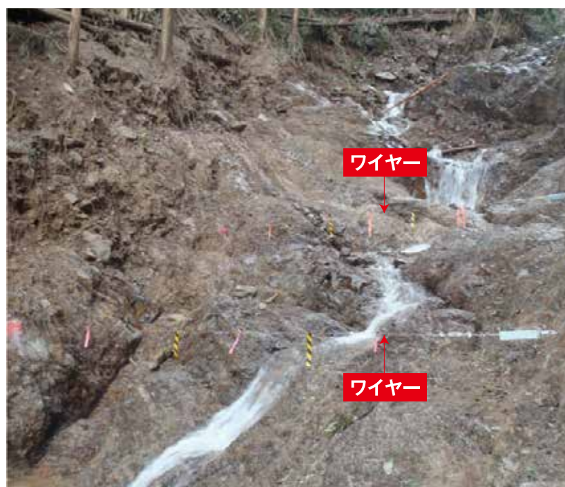
ワイヤーセンサー設置状況
