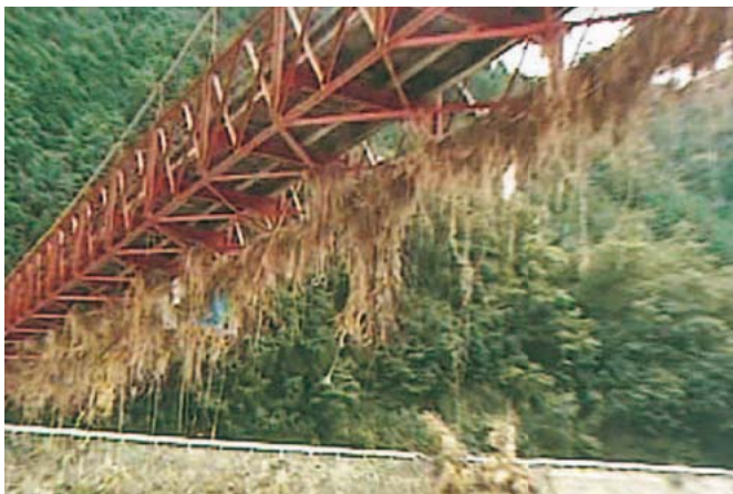
洪水痕跡（今井田地区筒瀬橋：22k900付近）
