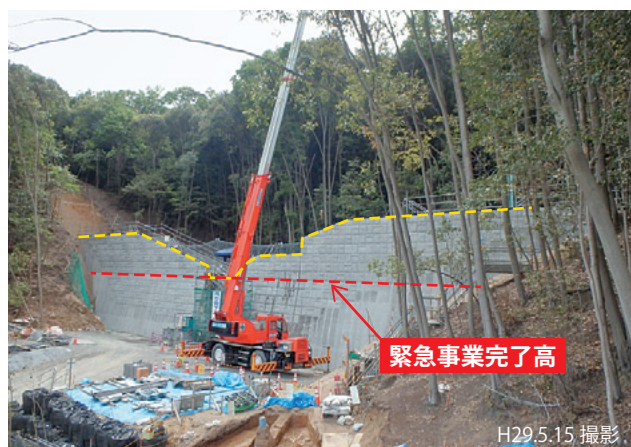
1003溪流（植林川砂防堰堤）安佐南区緑井8丁目
