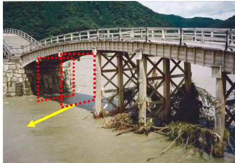
▲③錦川錦帯橋の橋脚の一部流失
