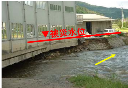
▲②支川玖島川玖島地区の河岸侵食
