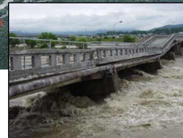
被災を受けた橋梁の例
