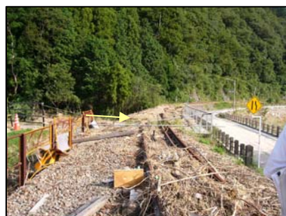
廃線跡に引っ掛かったゴミなど (鈴張川合流点付近)
