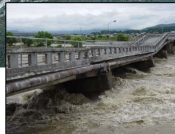
被災を受けた橋梁の例
