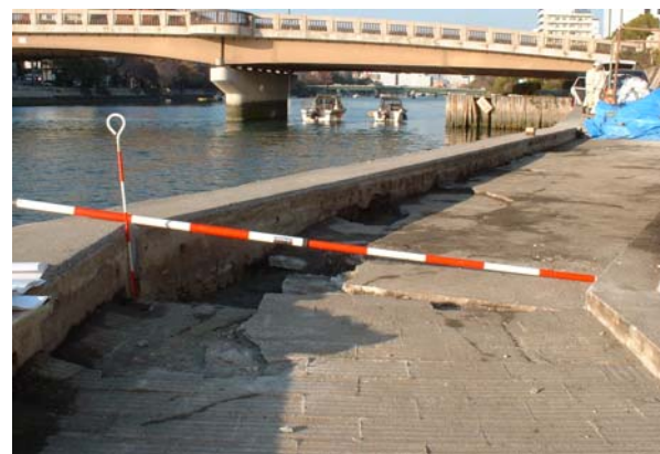
空洞化による天端の陥没(市内派川)
