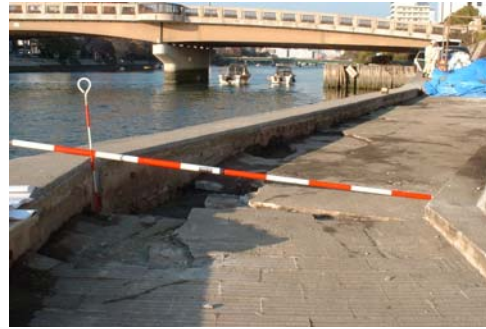
空洞化による天端の陥没(市内派川)
