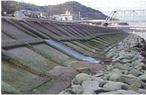
空洞化により歪みが生じている護岸(放水路)
