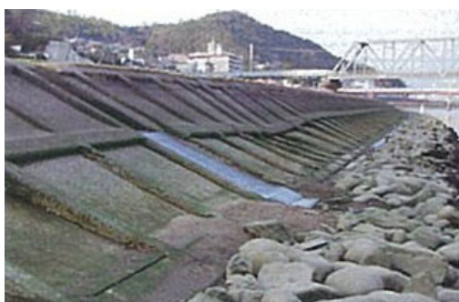
空洞化により歪みが生じている護岸(放水路)
