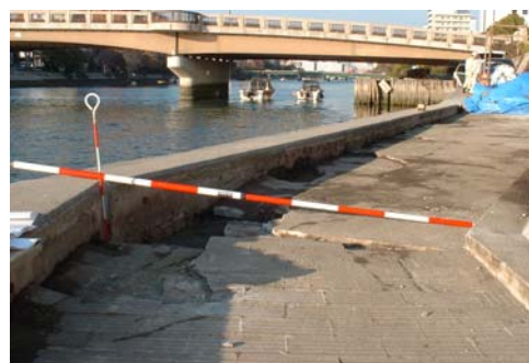
空洞化による天端の陥没(市内派川)
