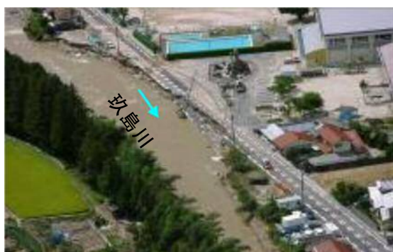
支川玖島川友和地区の河岸の被災
