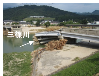
平成30年7月豪雨時の様子 (鳥声橋の流失)
