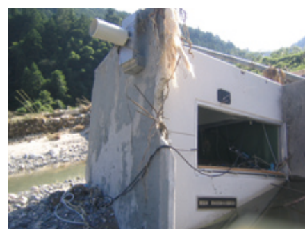
水内川湯来観測所被災状況
