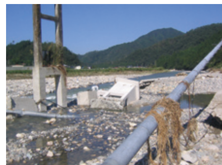
水内川湯来観測所被災状況
