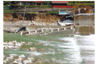
被災した護岸（上原堰堤付近）
