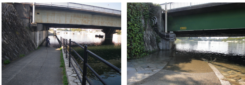
平成23年9月28日高潮でのアンダーパス冠水状況 三篠橋(左)と空鞆橋(右)
