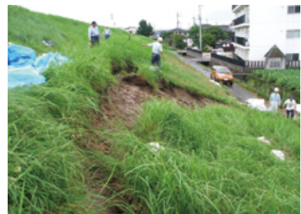
太田川右岸 12k500 法崩れ箇所
