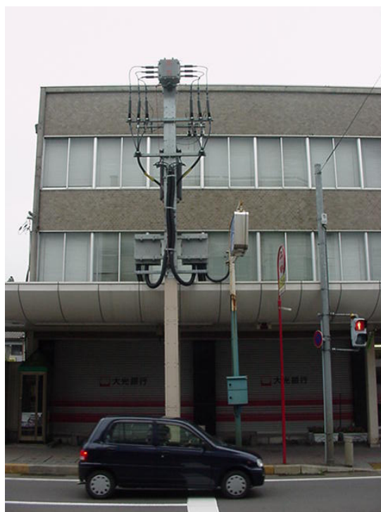
写真 1-5 アーケードポール方式実施箇所例
