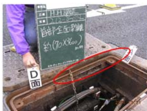
モルタル剥離
