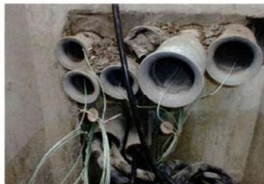
管路周辺の破損、およびせり出し
