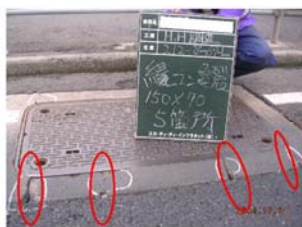
縁コンクリートひび割れ
