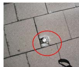
施錠部損傷・舗装欠損
