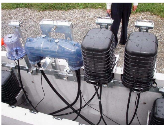
【通信機器の設置例】
