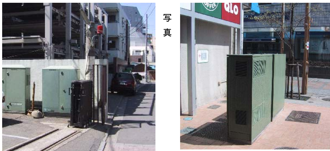
1-2 民地利用方式（地上機器設置）実施箇所例
